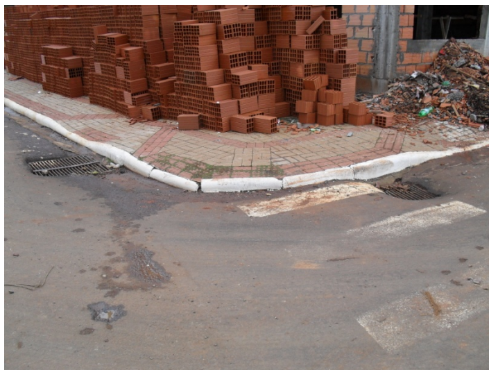
Figura 9.5 – Bocas de lobo na cidade de Serra Alta/SC.
