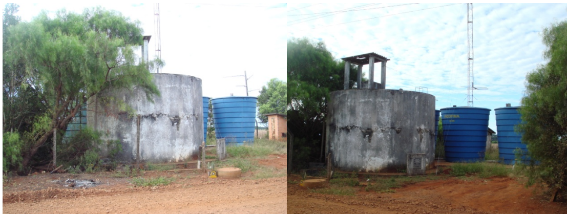
Figura 8.5 – Reservatório “A” de concreto de 75m 3 e 4 reservatórios de Fibra com 20m 3 para abastecimento da cidade de Serra alta/SC.
