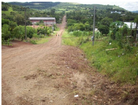
Figura 9.6 – Ausência de drenagem e pavimentação.
