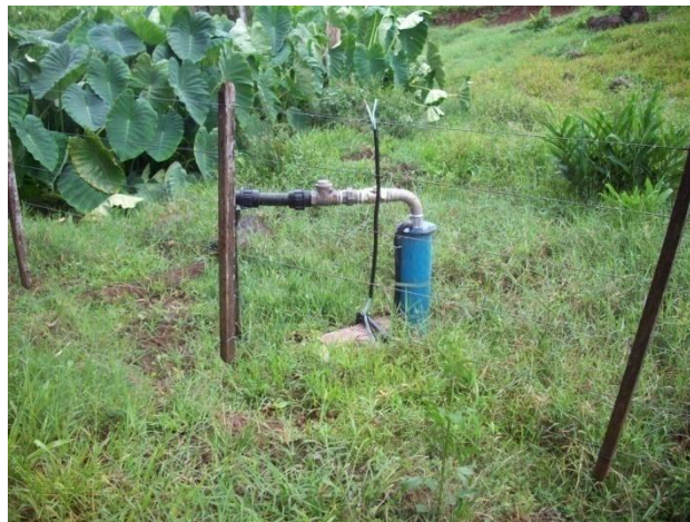
Figura 8.13 – Foto do Poço da Linha Marcelino – Área de APP
