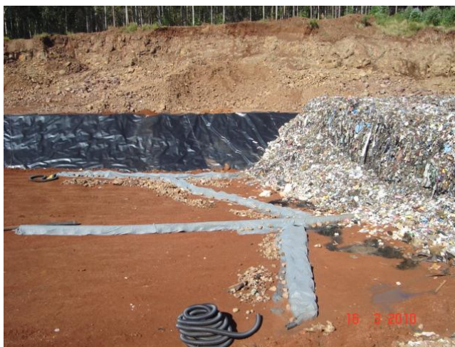
Figura 10.10 - Aterro Sanitário da empresa CONTINENTAL na cidade de Xanxerê – SC – Sistema de Drenagem
