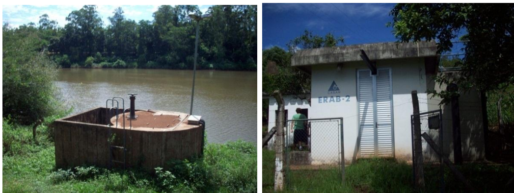
Figura 8.3 e 8.4. – Captação e Adutora de Água Bruta – CASAN (ERAB I e ERAB II)
