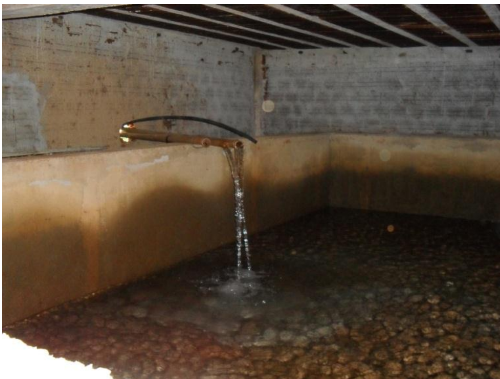
Figura 8.7– Filtro de carvão ETA - Planalto Alegre.
