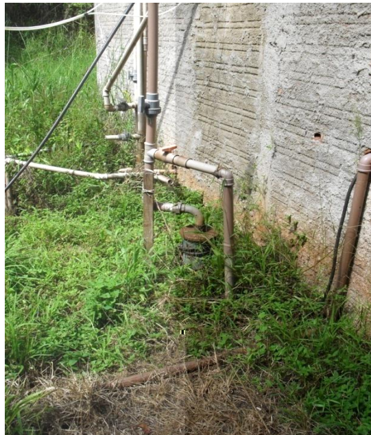
Figura 8.4. – Poço Artesiano- ETA
