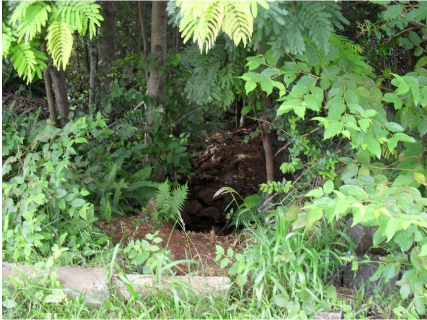
Figura 9.3 - Corpo receptor da rede pluvial.
