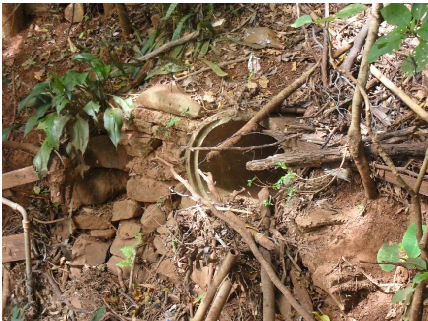
Figura 9.4 - Saída da Rede Pluvial
