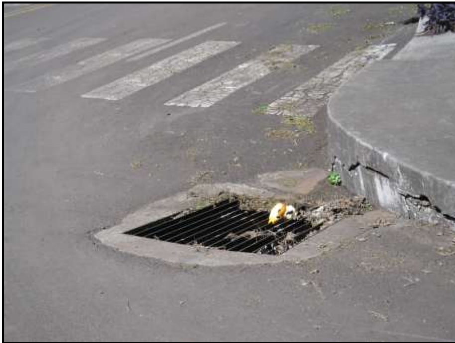
Figura 23: Boca de Lobo com grelha.
