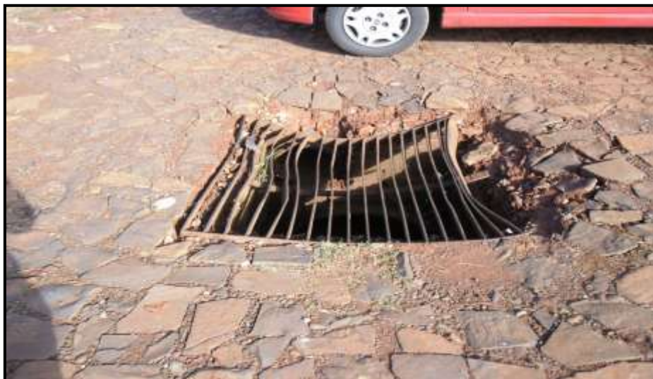
Figura 24: Boca de lobo com gralha em estado precário.
