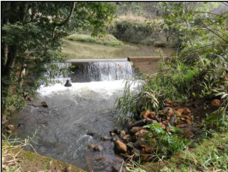
Figura 2: Captação 01 – Lageado Limeira.
