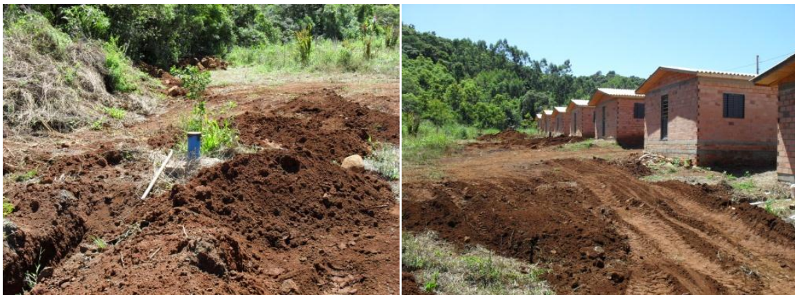
Figura 9.2 – Loteamento Zanella, sistema de esgotamento de “fossas negras”.
