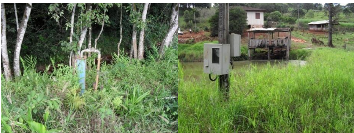
Figura 8.19 - Poço artesiano linha Sanga Lurdes, próximo a açude com chiqueiro.
