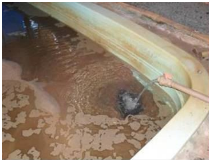
Figura 8.4 – Filtro de areia, ETA Nova Itaberaba.
