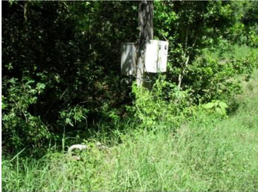
Figura 8.2- Poço artesiano, área de APP, abastece a ETA.
