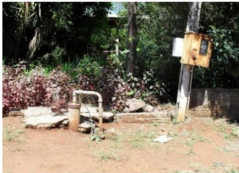
Figura 8.3 – Poço artesiano, utilizado somente na estiagem.
