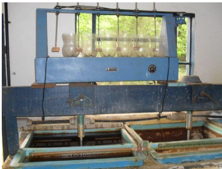
Foto 7 – Tanque de Preparo de Sulfato de Alumínio
