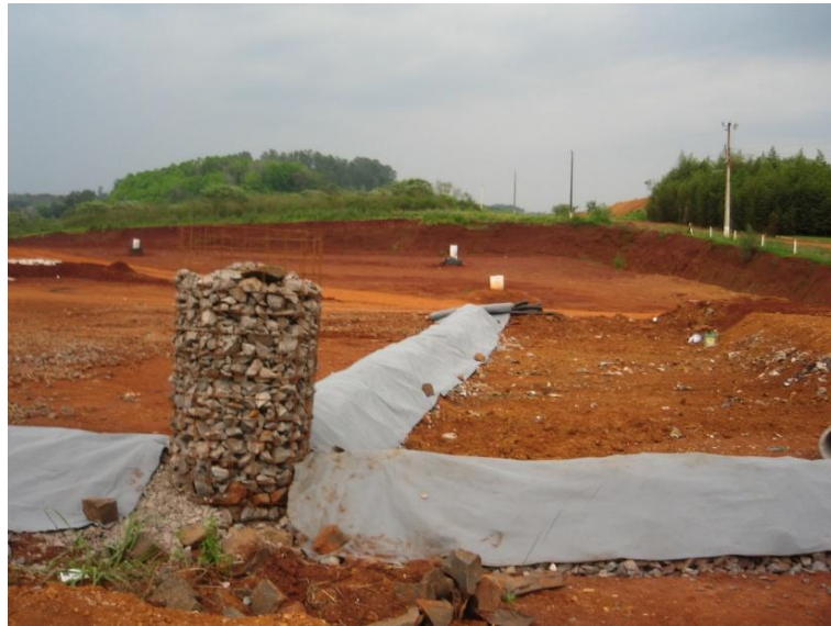
Foto 21 - Drenos de gás
