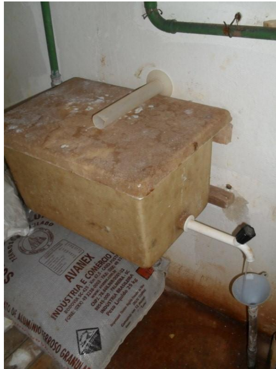
Foto 8 – Dosador de Flúor
