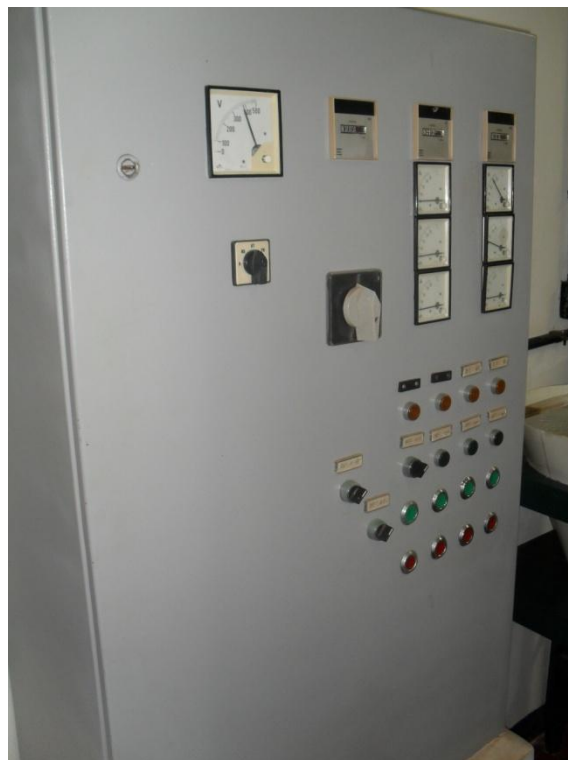
Foto 12 - Quadro comando ERAT 01
