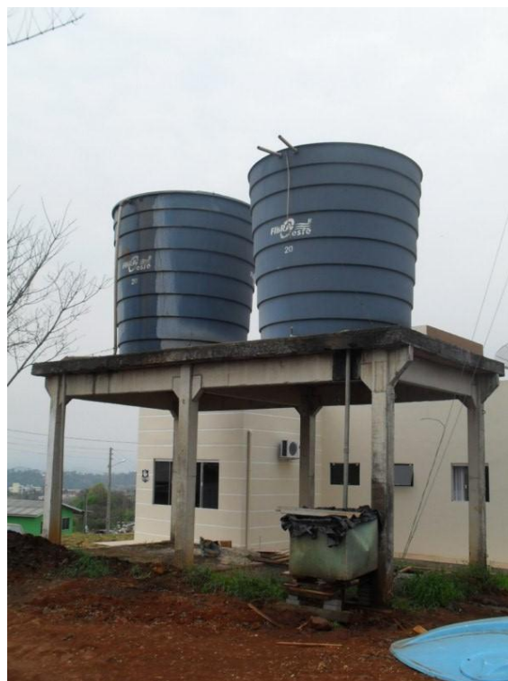
Foto 14 – Conjunto de Reservação R - 02
