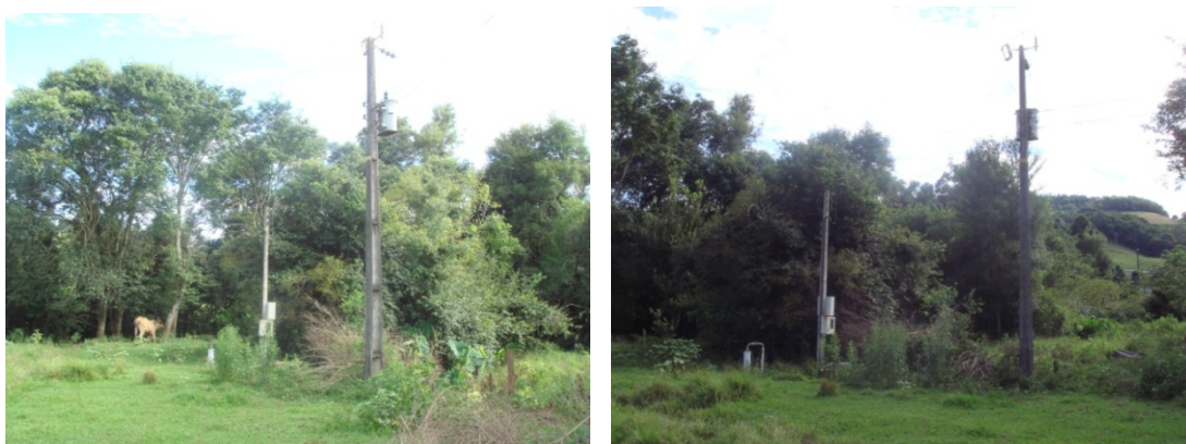
Figura 8.9 – Poço profundo – linha Flor
