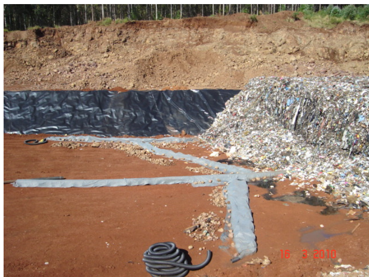
Figura 10.11 -Aterro Sanitário da CONTINENTAL-Xanxere/SC – Sistema de Drenagem
