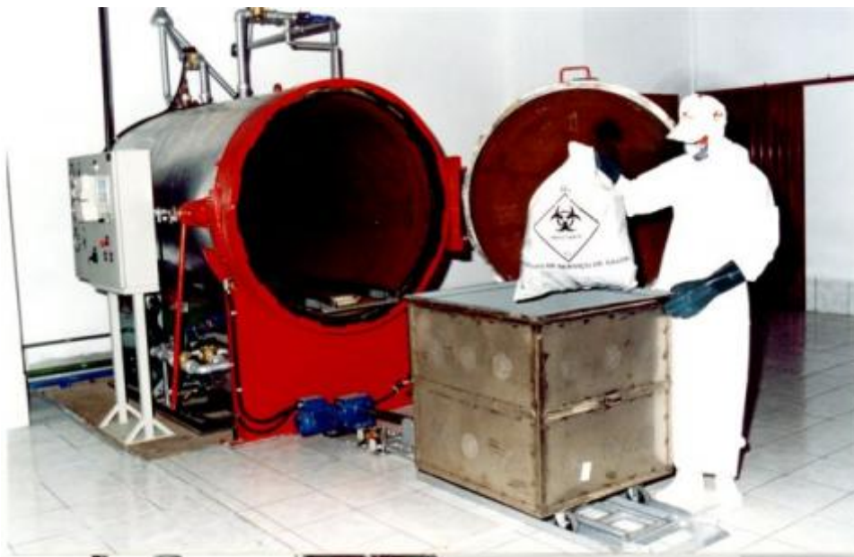
Figura 10.8 -Autoclave empresa TUCANO Obras e Serviços Ltda
