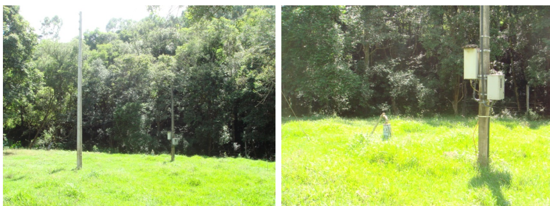
Figura 8.23 – Poço profundo – linha Quatro
