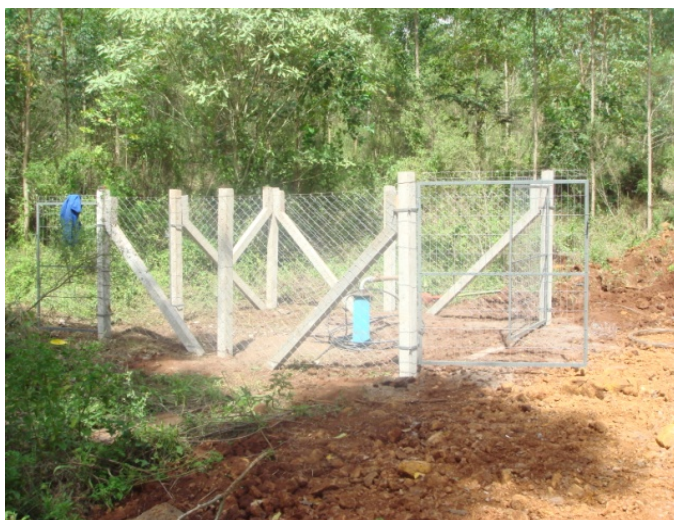
Figura 8.21 – Poço profundo – linha Santo Antônio
