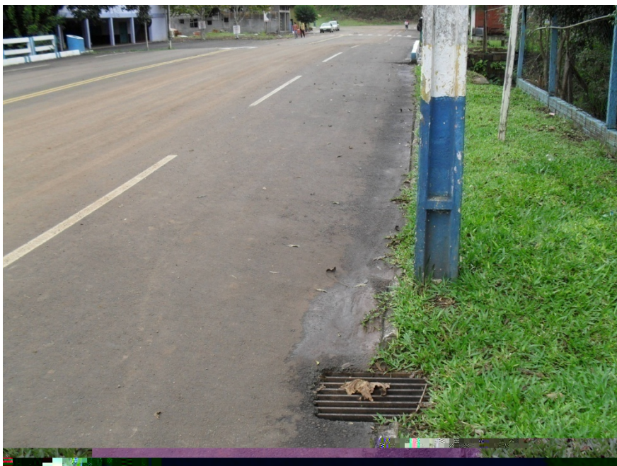
Figura 9.7 – Boca de Lobo
