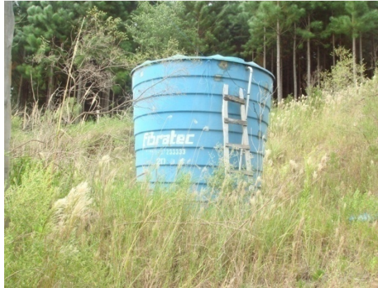
Figura 8.4 – Reservatório “A” fibra de vidro de 20m 3
