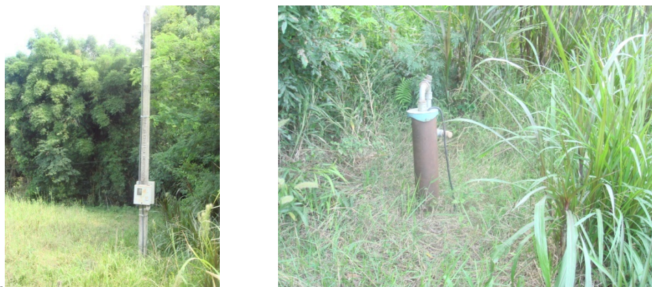
Figura 8.17 – Poço profundo – linha Canarinho
