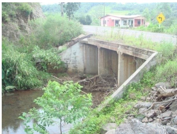
Figura 9.6 – Ponto de inundação – Saída para Jardinópolis
