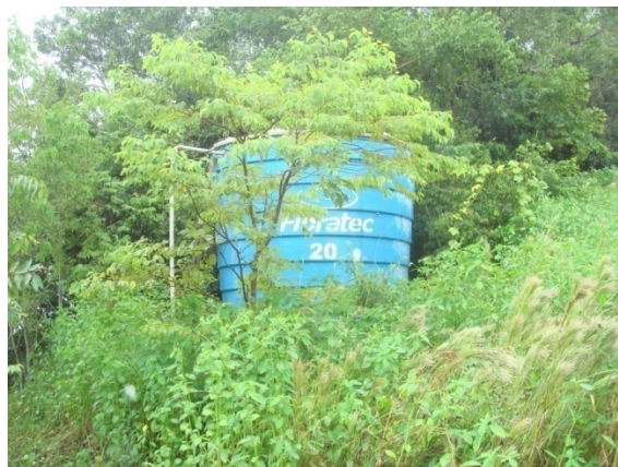
Figura 8.5 – Reservatório “B” fibra de vidro de 20m 3
