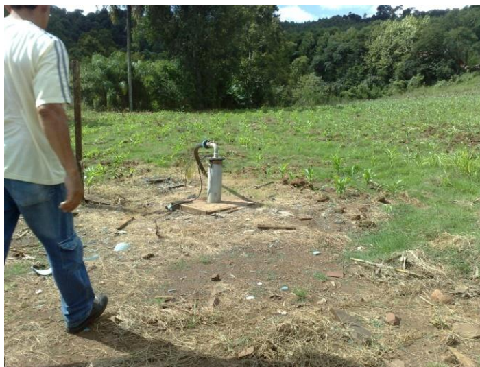
Figura 8.15. - Poço artesiano linha Três Irmãos.
