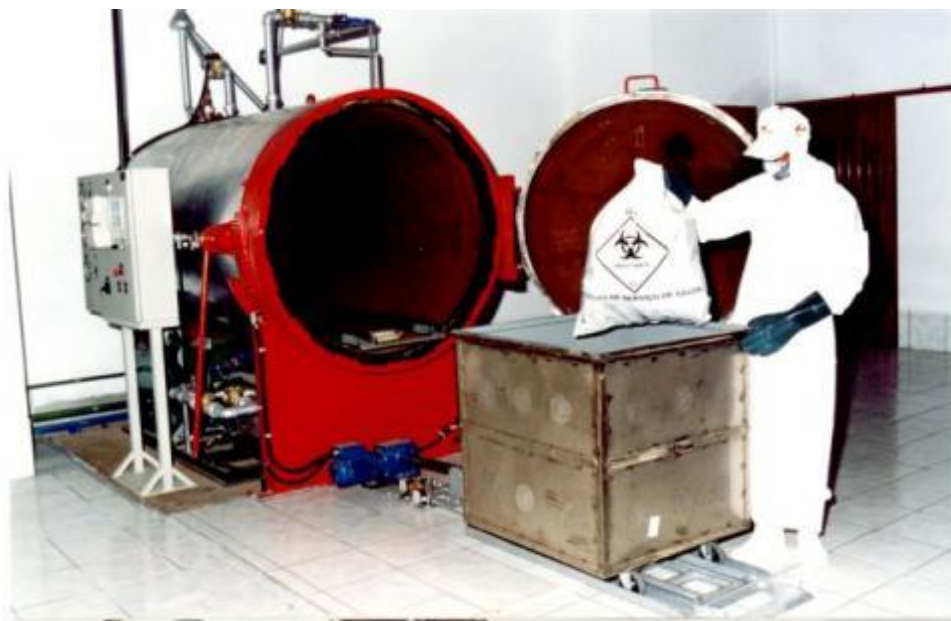
Figura 11.8. - Autoclave empresa TUCANO Obras e Serviços Ltda.
