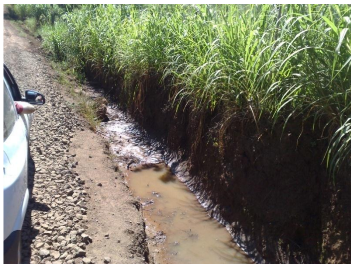
Figura 10.5. - Ponto de alagamento, rua Rugero Dal Santo.
