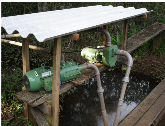
Figura 8.3 – Captação água bruta Lajeado São José. FONTE: Consórcio MPB/ESSE/Sanetal.
