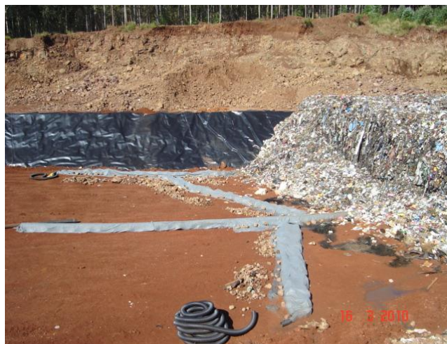
Figura 11.11. -Aterro Sanitário da empresa CONTINENTAL na cidade de Xanxerê – SC – Sistema de Drenagem.
