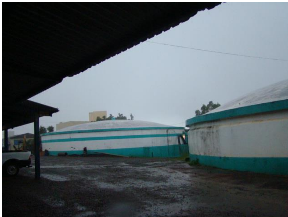
Figura 39: Reservatórios R1 A e B pertencentes ao conjunto R1 situado perto da ETA no bairro São Cristóvão
