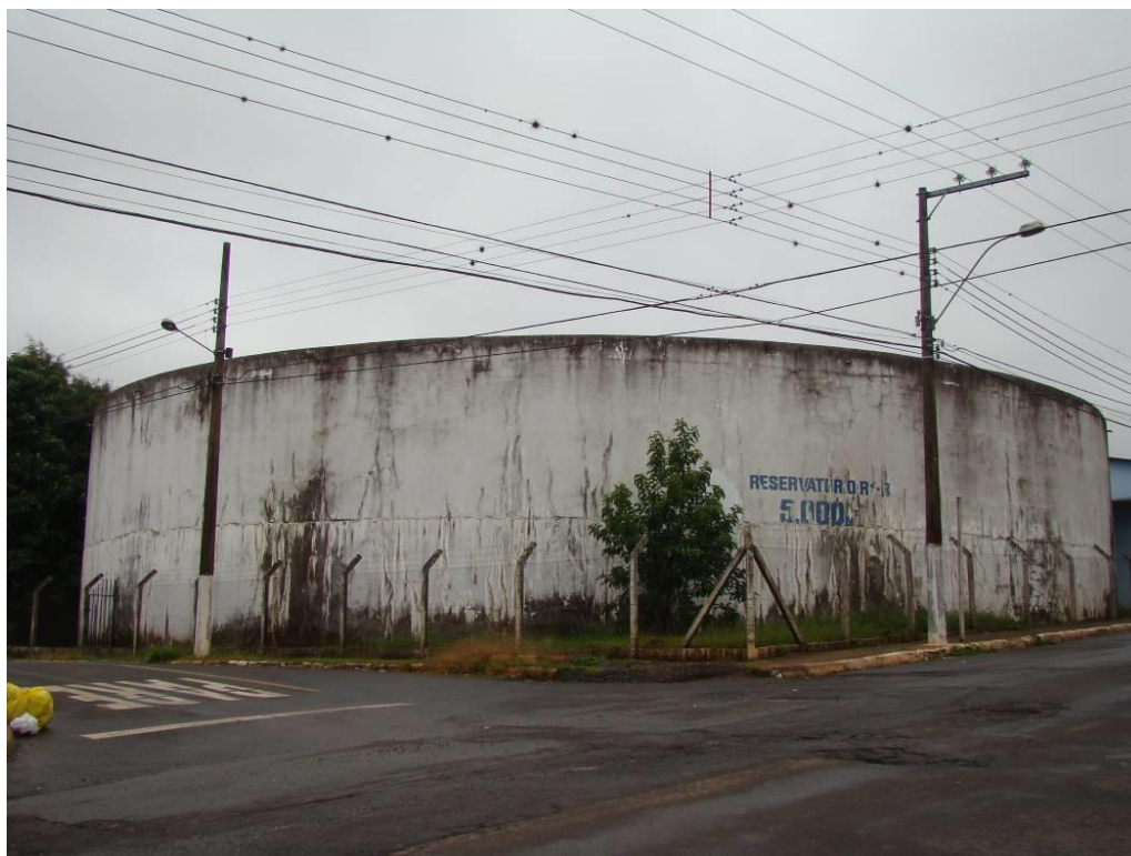
Figura 1: Reservatório central necessitando manutenção
