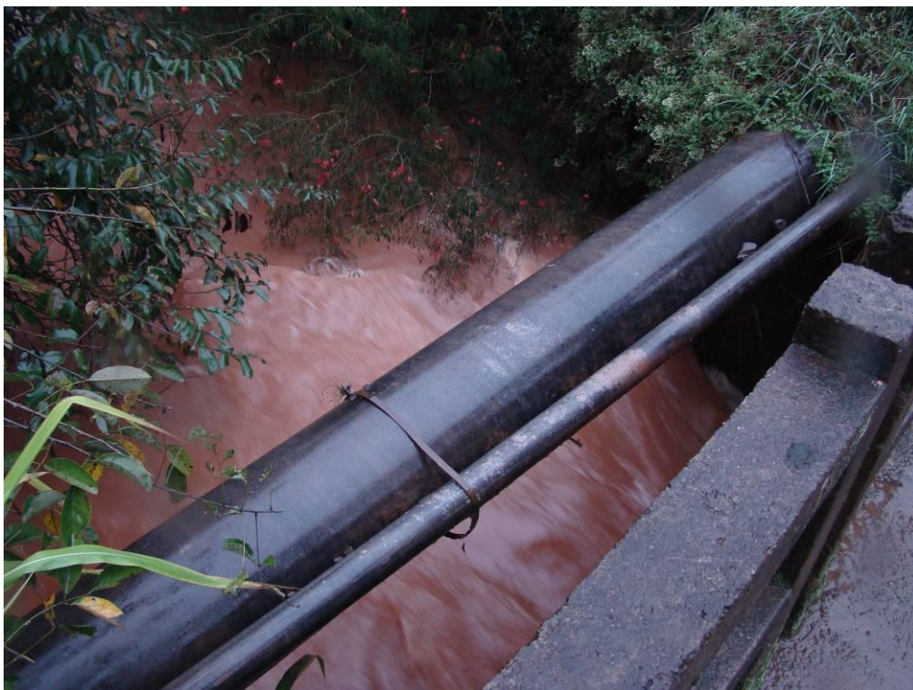
Figura 25: Detalhe da adutora de água bruta a jusante da barragem do Engenho Braun
