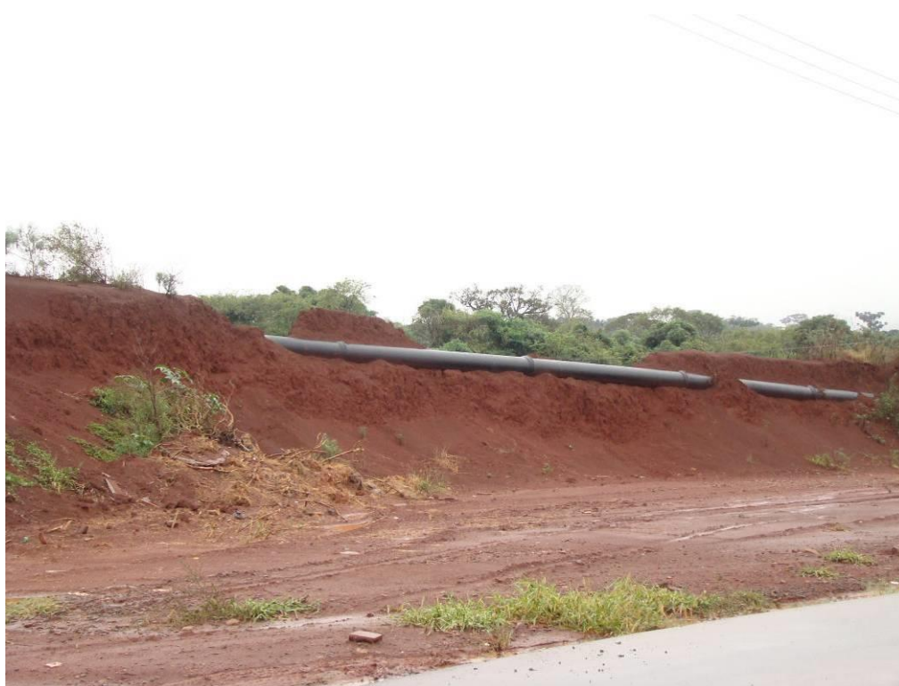
Figura 28: Adutora de água bruta do Lajeado do Tigre em frente ao Frigorífico Aurora (Altitude: 632m)
