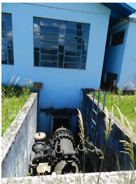
Figura 27: Adutora de água bruta do Lajeado do Tigre
