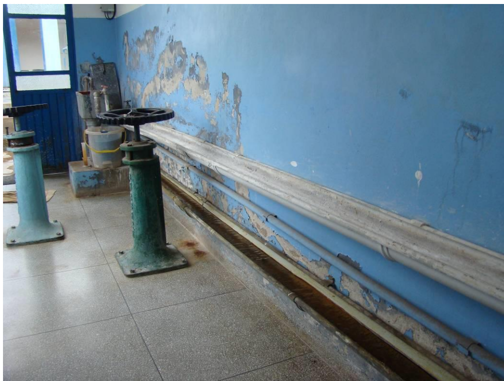
Figura 3: Calha do dosador de produtos químicos da ETA
