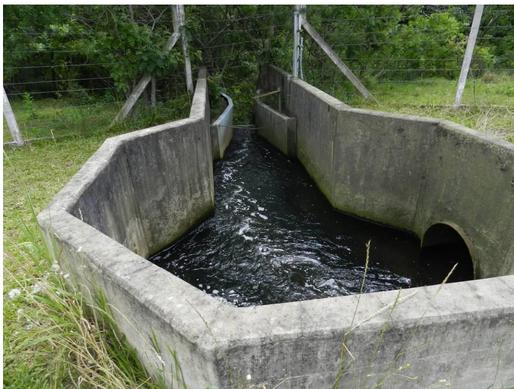
Figura 58: Efluente tratado lançado no corpo receptor
