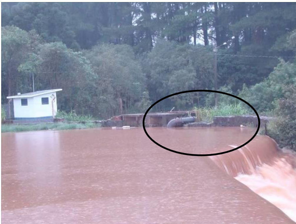
Figura 20: Captação na barragem Engenho Braun (Foto de 22/04/10 – precipitação de 95 mm em 24horas)
