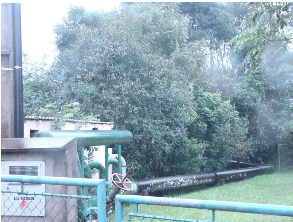
Figura 24: Detalhe da adução de água bruta na estação elevatória
