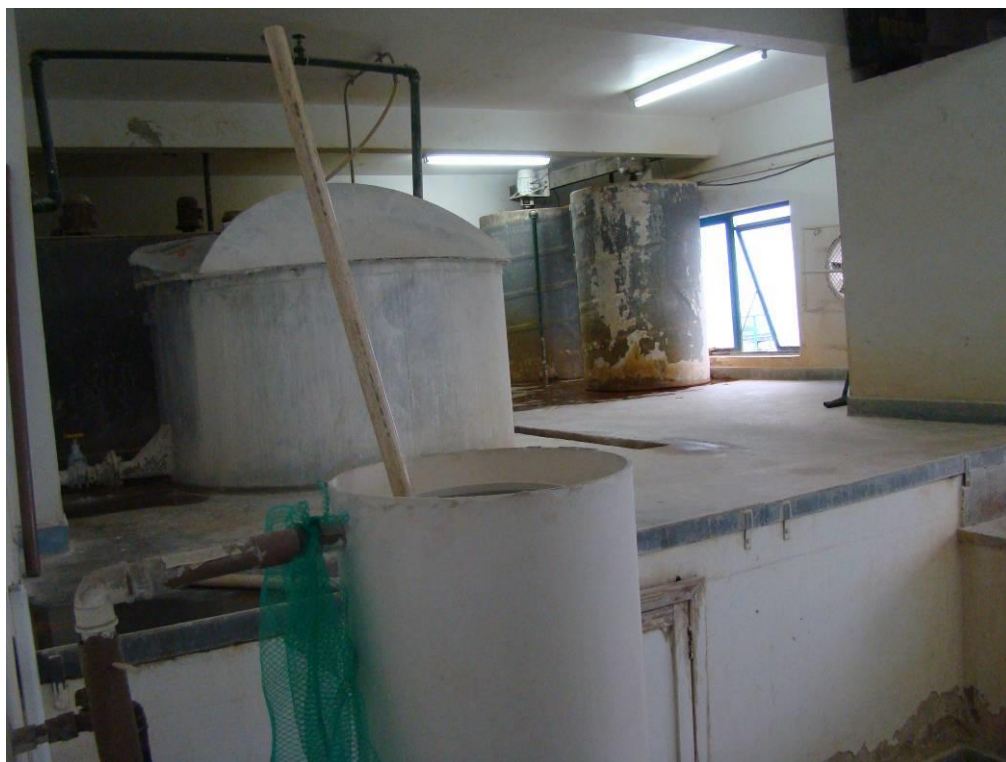
Figura 5: Sala de produtos químicos da ETA
