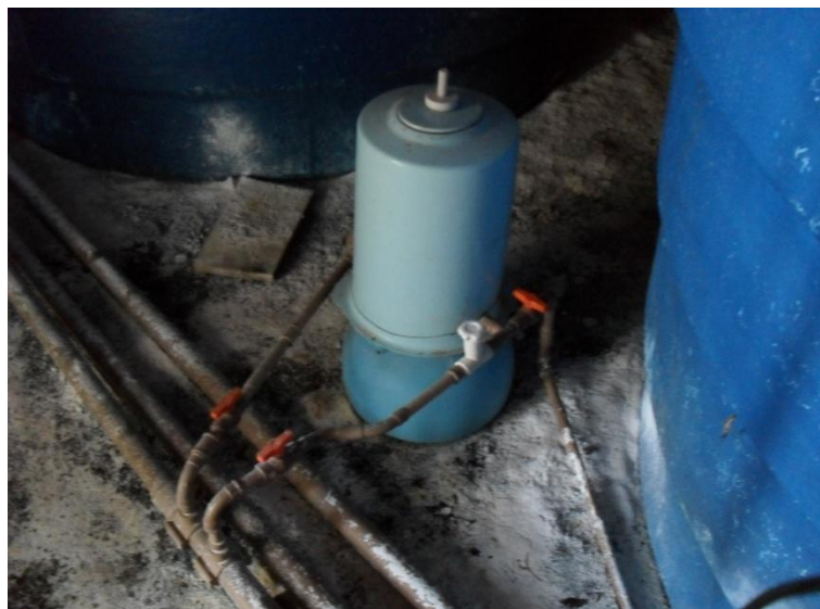
Foto 9 – Filtro na saída dos reservatórios
