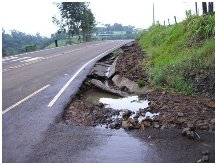
Figura 10.11– Acesso ao município com drenagem insuficiente para escoamento das águas da chuva.
