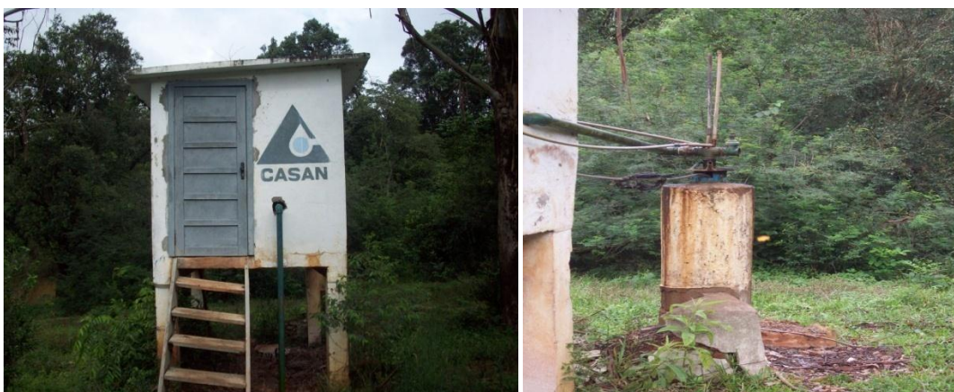
Figura 8.1 e 8.2 – Poço profundo, administração CASAN. FONTE: Consórcio MPB/ESSE/Sanetal.
