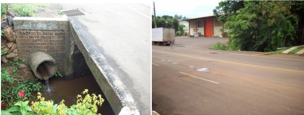
Figura 10.5 e 10.6. - Ponto de alagamento, Rua Santa Catarina.
