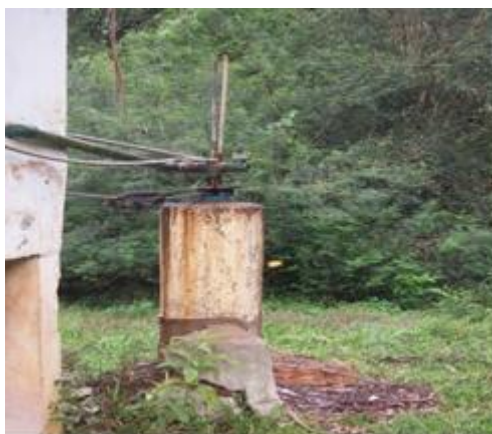
Figura 8.4– Poço Profundo administração CASAN.
