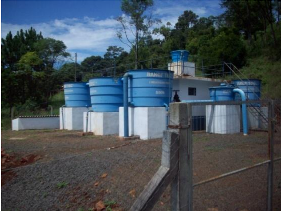
Figura 8.10. – Estação de tratamento de água, Linha Porto.
