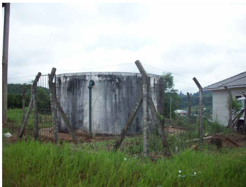
Figura 8.6– Reservatório 40m³, administração CASAN.
