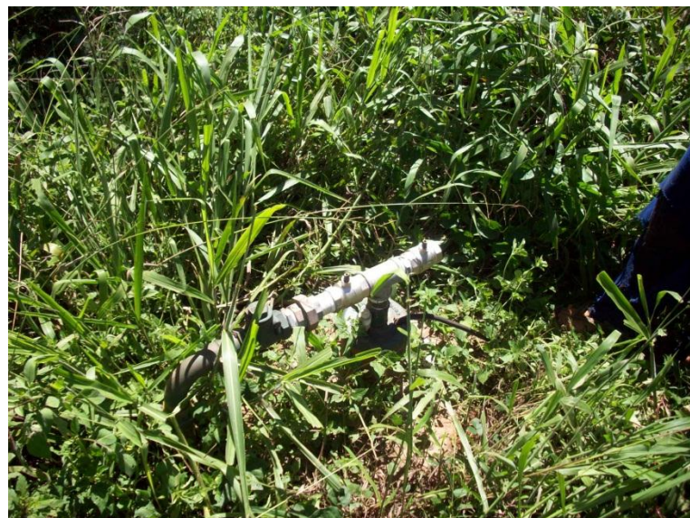
Figura 8.11 – Poço Artesiano Linha Lamedor.
