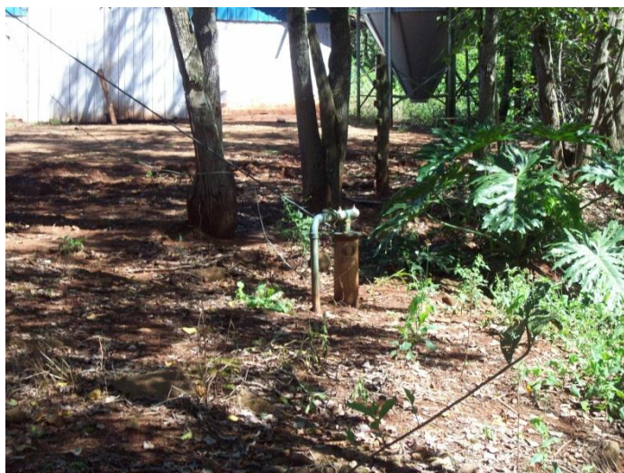
Figura 8.14. – Poço artesiano linha Humaitá.
