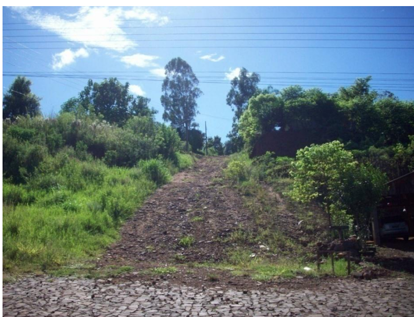
Figura 9.6 – Rua Índio Condá, sem pavimentação , ausência de drenagem.
