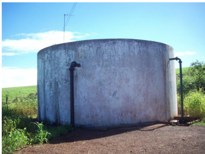
Figura 8.6 – Reservatório CASAN, 400m 3 .
