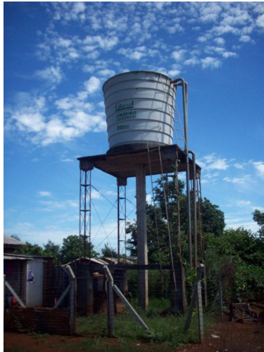
Figura 8.8 – Reservatório elevado Bairro Antena.
