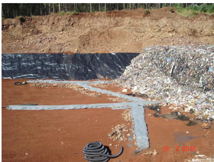
Figura 10.10. -Aterro Sanitário da empresa CONTINENTAL na cidade de Xanxerê – SC – Sistema de Drenagem
