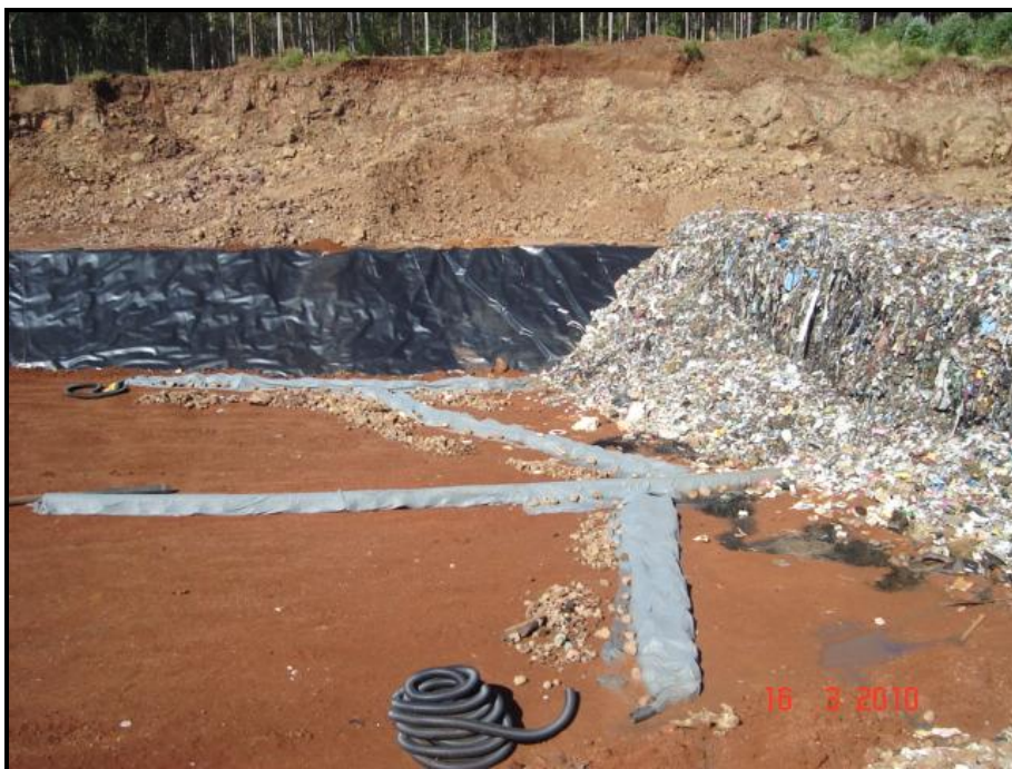
Figura 12: Aterro Sanitário da Empresa Continental- Sistema de Drenagem.
