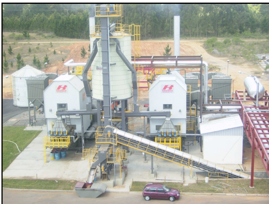
Figura 10: Modulo Gerador de Energia Elétrica
