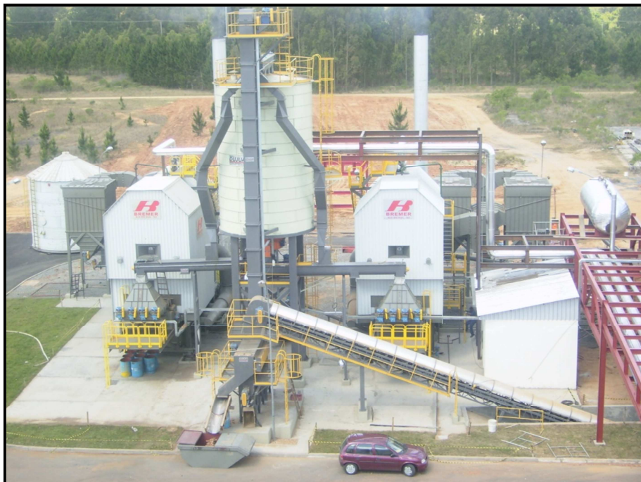
Figura 10: Modulo Gerador de Energia Elétrica
