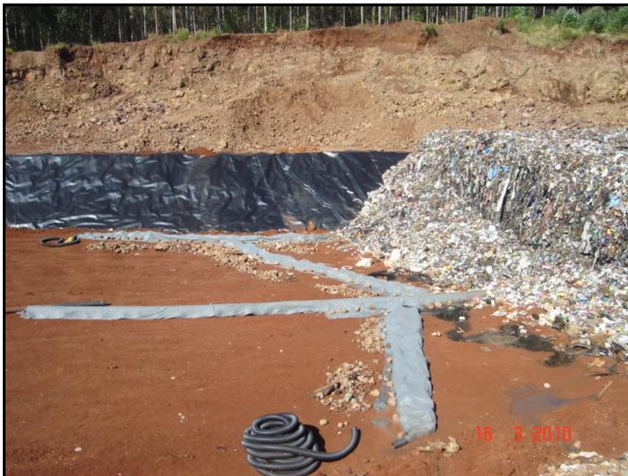
Figura 12: A terra Sanitário da Empresa Continental - Sistema de Drenagem.
