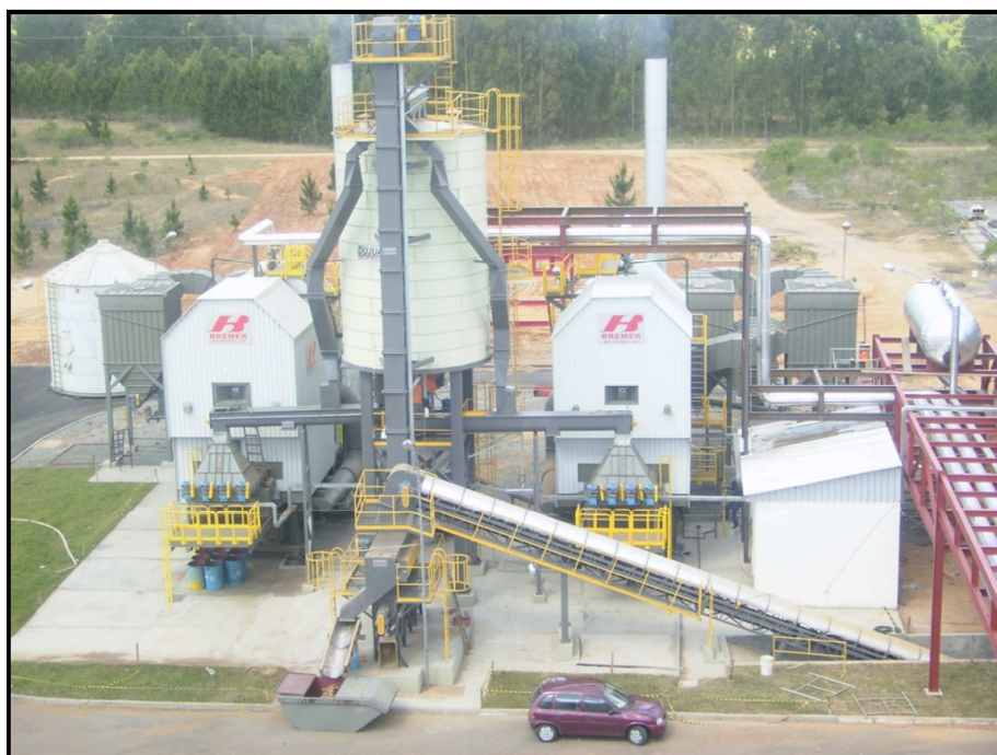
Figura 10: Modulo Gerador de Energia Elétrica
