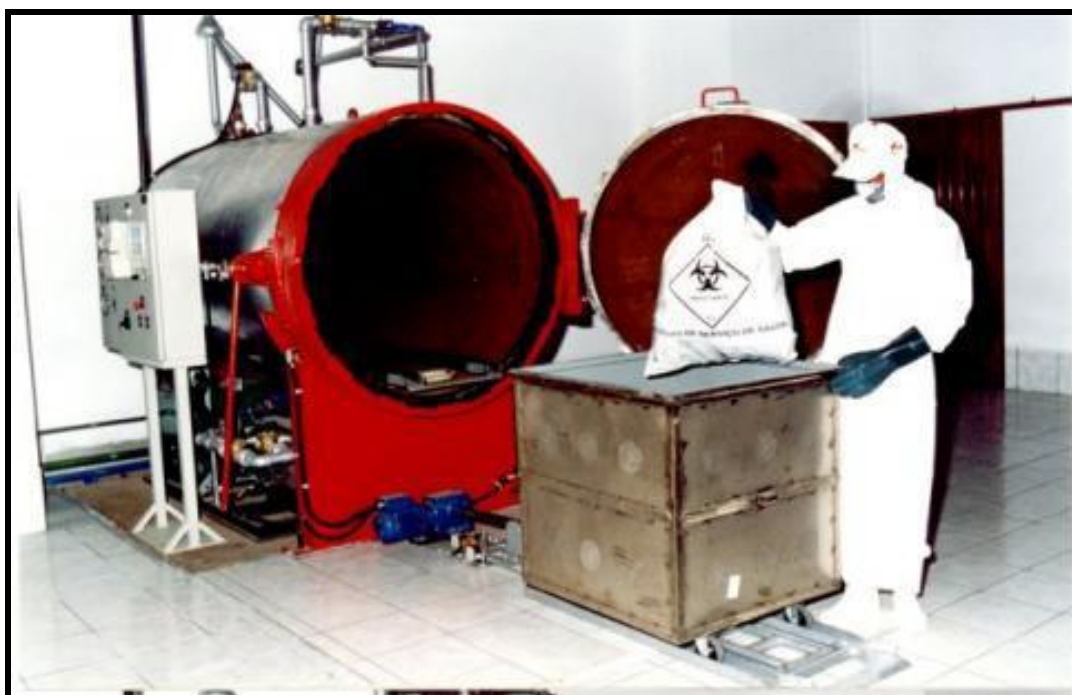
Figura 10: Autoclave empresa TUCANO Obras e Serviços - Unidade I - Saudades-SC
