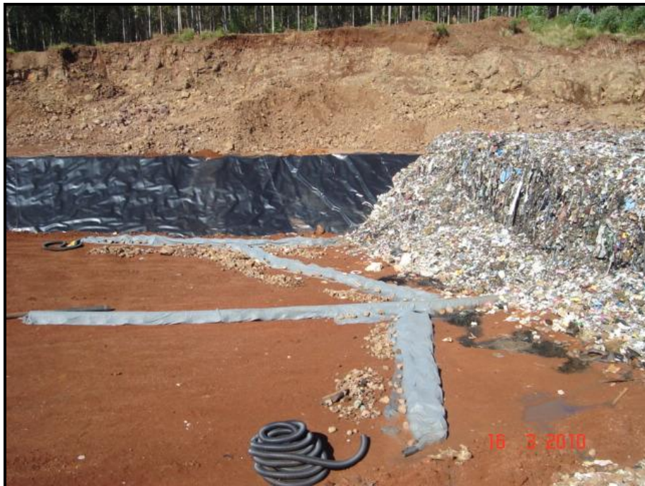
Figura 12: Aterro Sanitário da Empresa Continental - Sistema de Drenagem.
