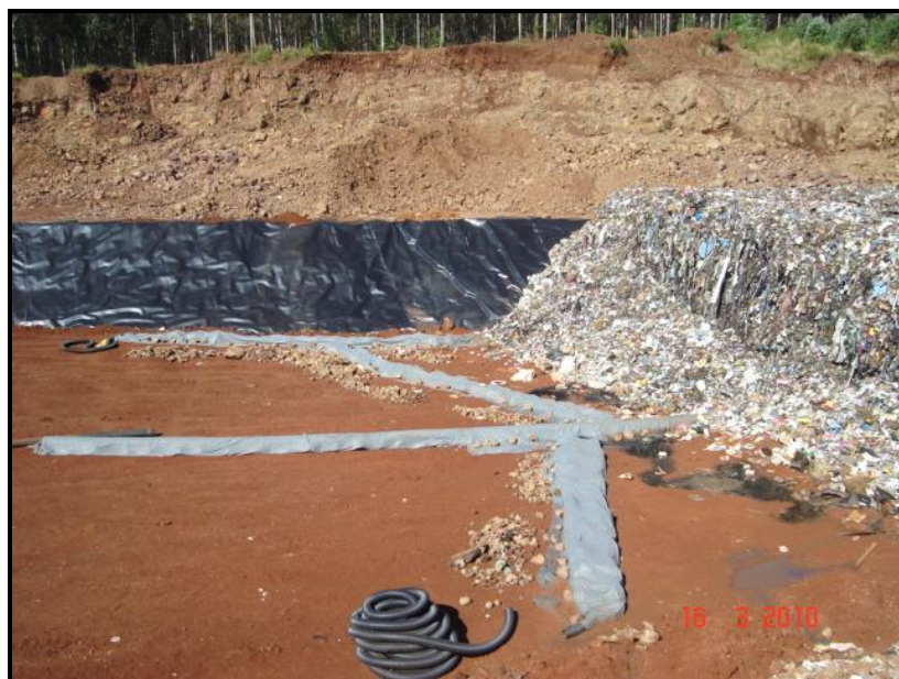
Figura 12: A terro Sanitário da Empresa Continental- Sistema de Drenagem. Fonte: PMSB (2011).
