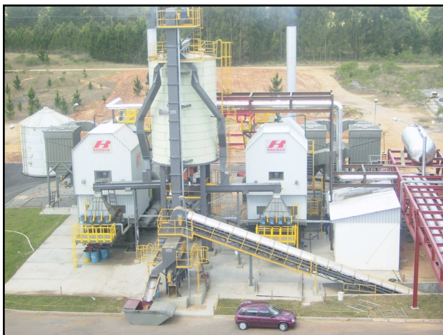
Figura 10: Modulo Gerador de Energia Elétrica
