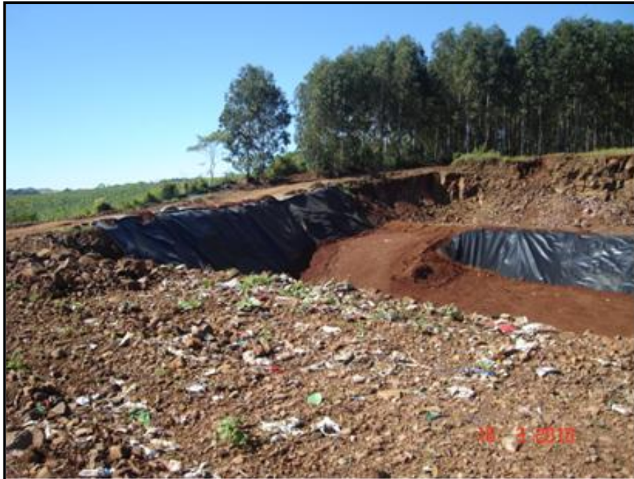
Figura 16: Aterro Sanitário da Empresa Continental – Disposição Final Fonte: PMSB.
