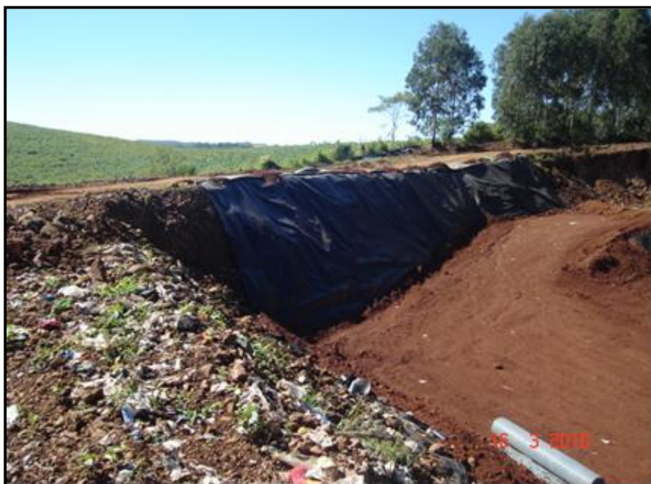
Figura 17: Aterro Sanitário da Empresa Continental – Disposição Final Fonte: PMSB.
