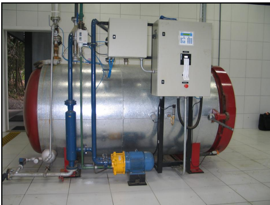
Figura 20: Autoclave da empresa Continental Obras e Serviços.
