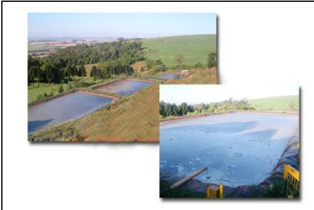
Figura 14: Aterro Sanitário da Empresa Continental - Sistema de Tratamento de líquidos e percolados.
