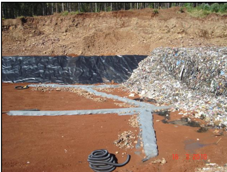
Figura 13: Aterro Sanitário da Empresa Continental- Sistema de Drenagem.
