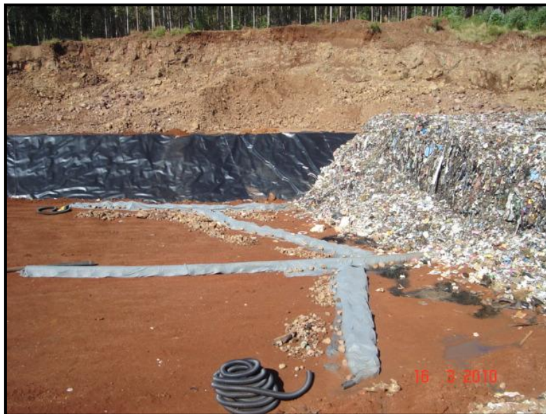
Figura 14: Aterro Sanitário da Empresa Continental- Sistema de Drenagem.
