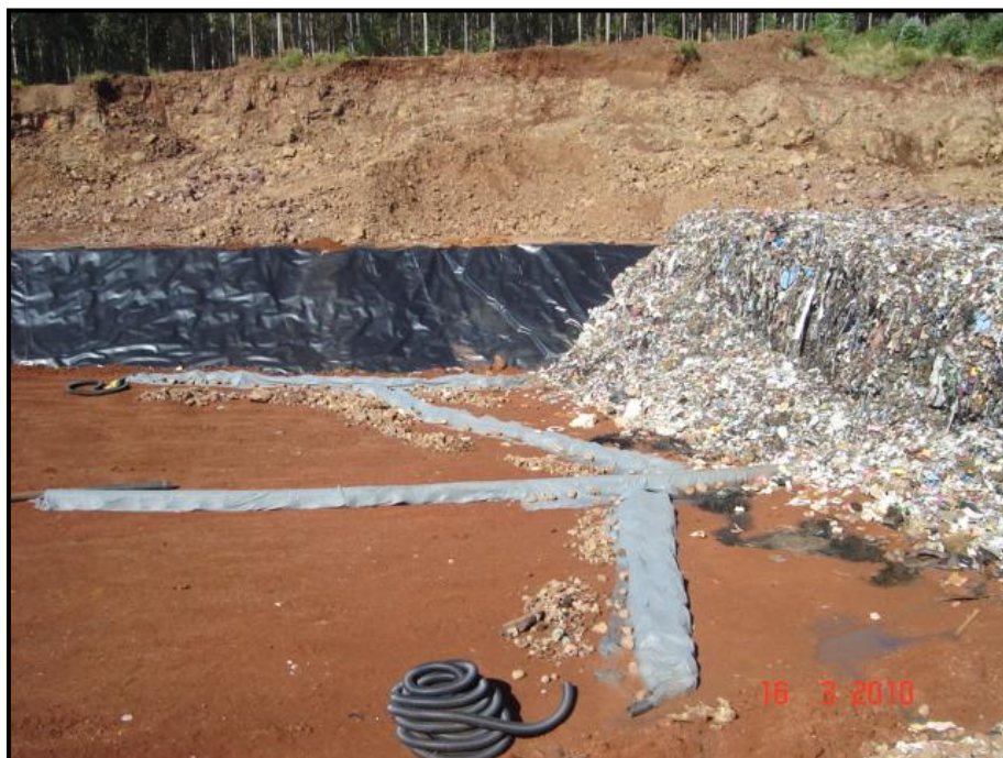
Figura 11: Aterro Sanitário da Empresa Continental- Sistema de Drenagem.
