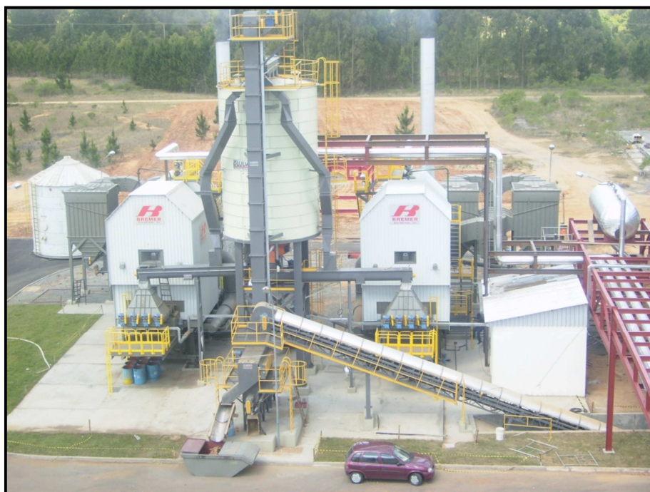
Figura 10: Módulo Gerador de Energia Elétrica
